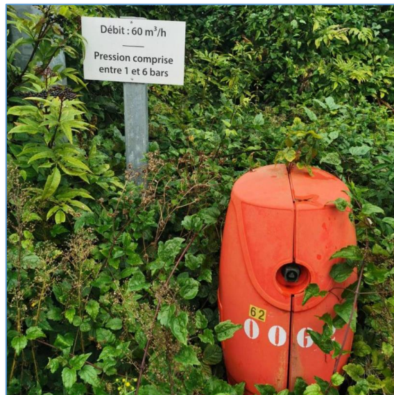
Fig. 6 : Borne incendie sur le site (réseau public)
