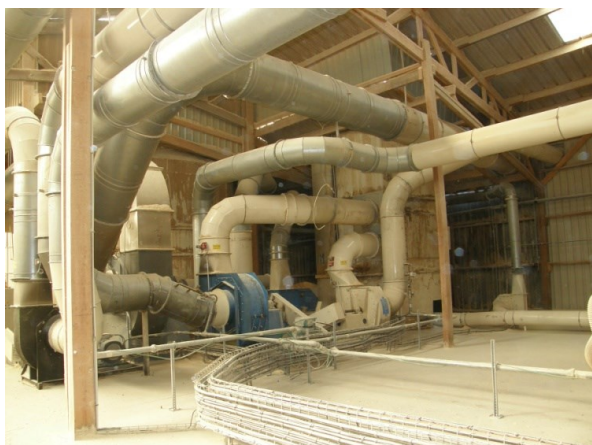
Photo 40 : Conduites de transport
