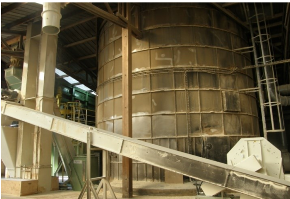
Photo 17 : Silo à copeaux
