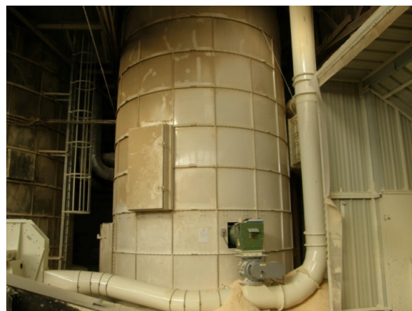
Photo 43 : Silo à sciure
