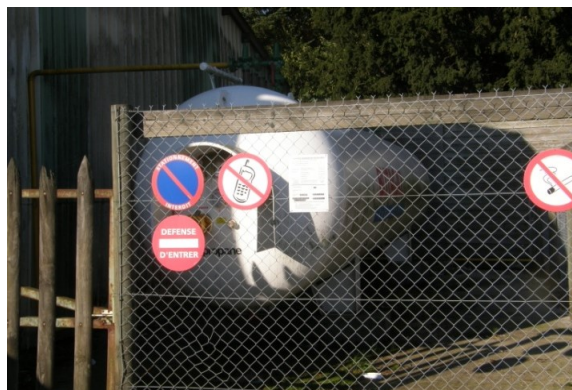
Photo 27 : Citerne de gaz
