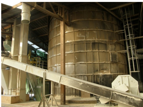
Photo 42 : Silo à copeaux
