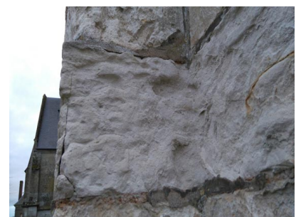
Desquamation (Église de Hauville)
