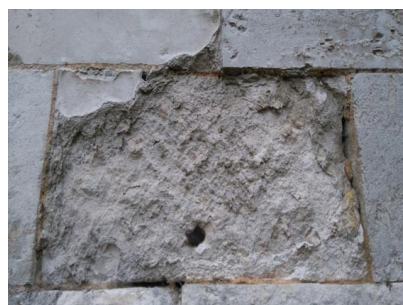
Desquamation et Pulvéulence (Église de Hauville)
