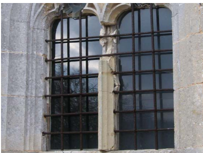
Oxydation du fer (Église de Sebecourt)
