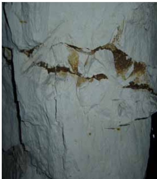
Pilier présentant des signes de fracturations (photo DDTM27)
