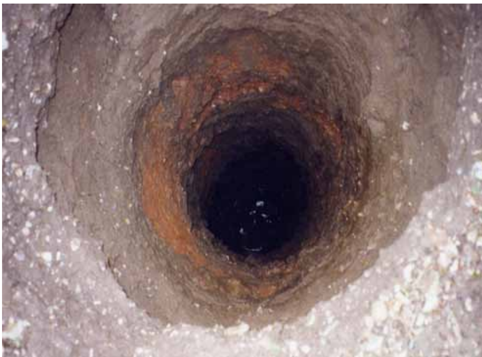
Puits de marnière non maçonné (photo DDTM 27)
