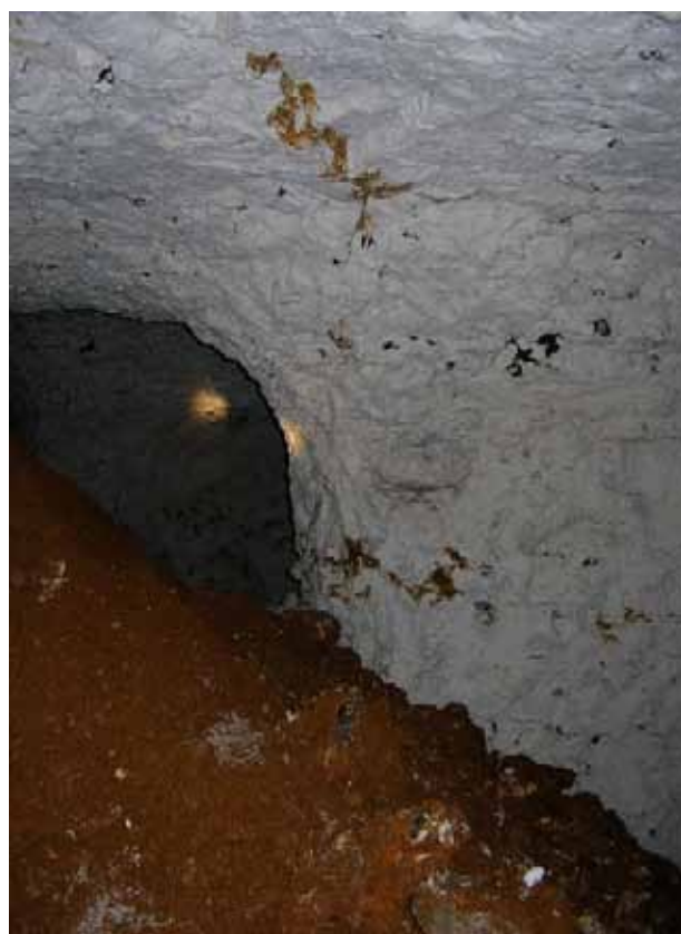
Fluage d'argile à l'intérieur d'une marnière (photo DDTM 27)
