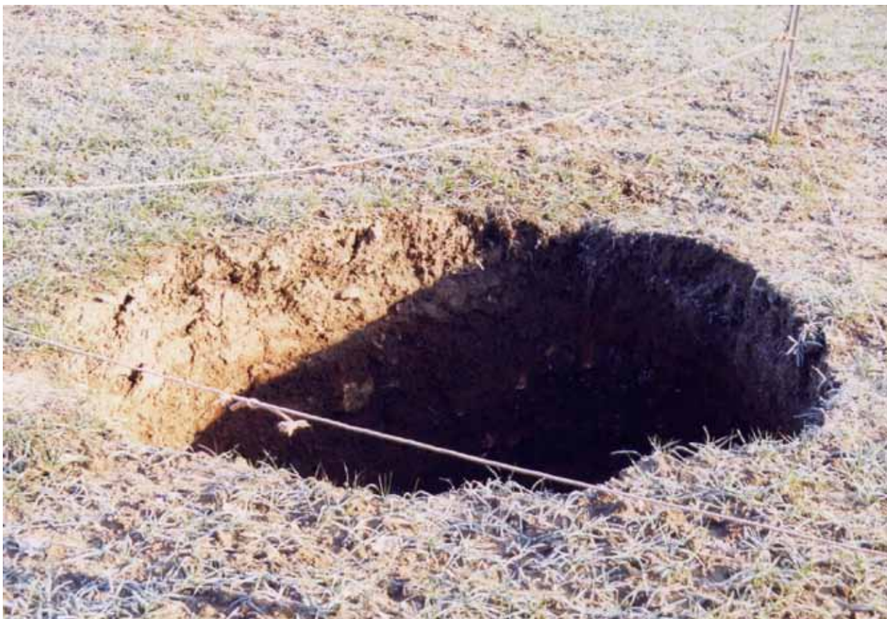
Désordre lié à un effondrement partiel de marnière (photo DDTM 27)
