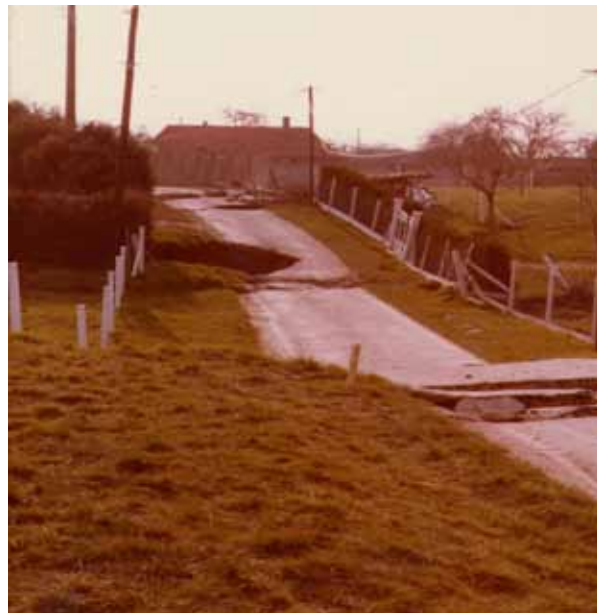
Désordre lié à un effondrement généralisé de marnière (photo DDTM27)
