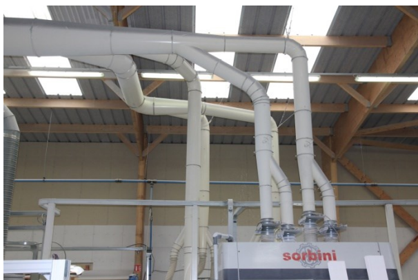
Photo 79 : Captage des émissions de la ligne de peinture
