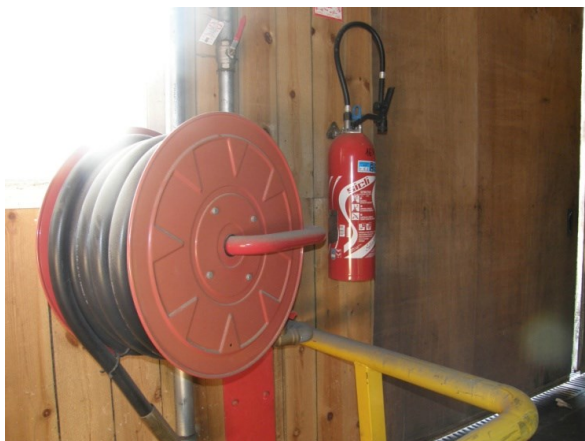
Photo 85 : RIA et extincteur
