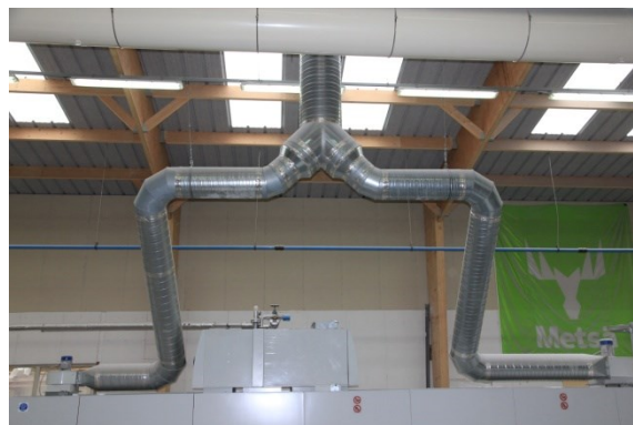
Photo 80 : Captage des émissions de la ligne de peinture
