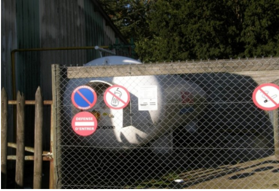
Photo 36 : Citerne de propane
