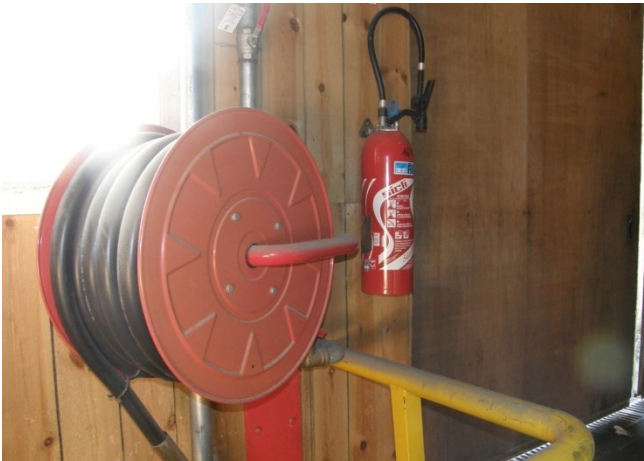
Photo 45 : RIA et extincteur
