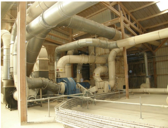
Photo 37 : Conduites de transport
